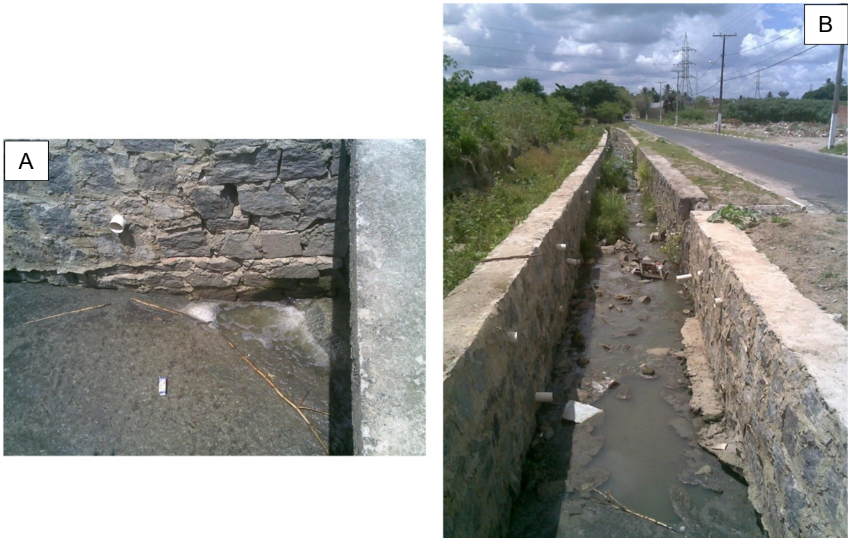
Figura 17 - Condições estético-sanitárias à jusante do ponto de coleta 01
