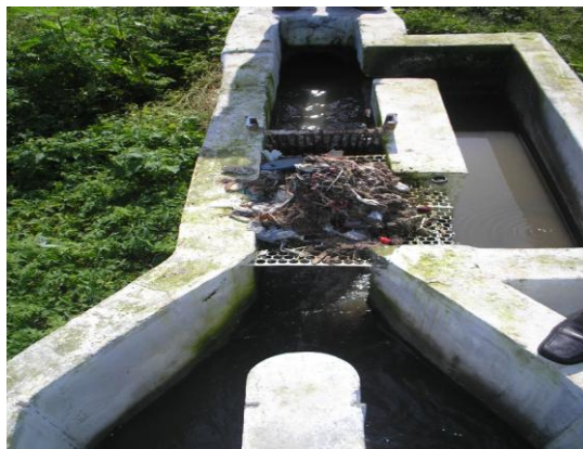
FIGURA 04. Parte da ETE Homero Figueiredo (gradeamento).
