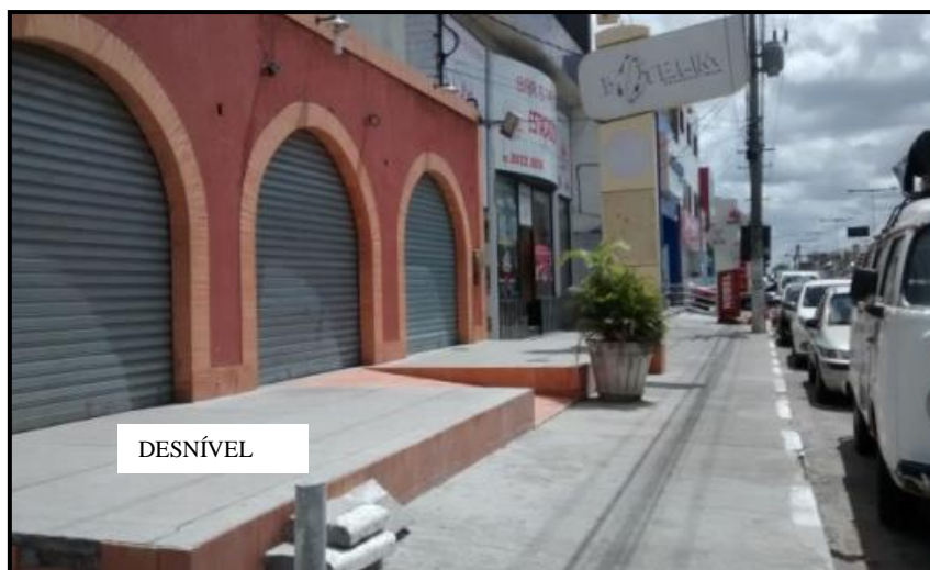
Figura 3. 25 Passeios com desníveis, avenida João Durval, Feira de Santana, 2018
