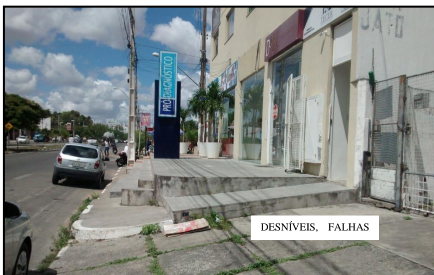
Figura 3. 38: Passeios com desníveis, avenida Fraga Maia, Feira de Santana, 2018
