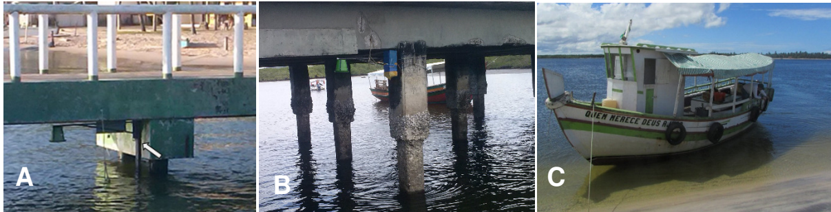
Figura 8 – Instalação dos MDU: A) no cais do porto da Barra do Serinhaém, B) no cais do porto de Ituberá e C) Embarcação utilizada para amostragem da salinidade.
