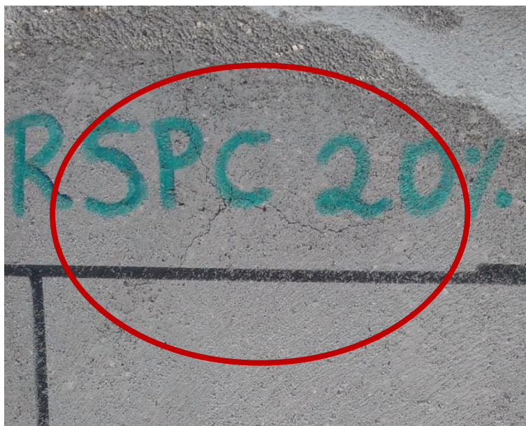
Figura 57 - Fissuras presentes no painel produzido com a argamassa 20%RSPC
